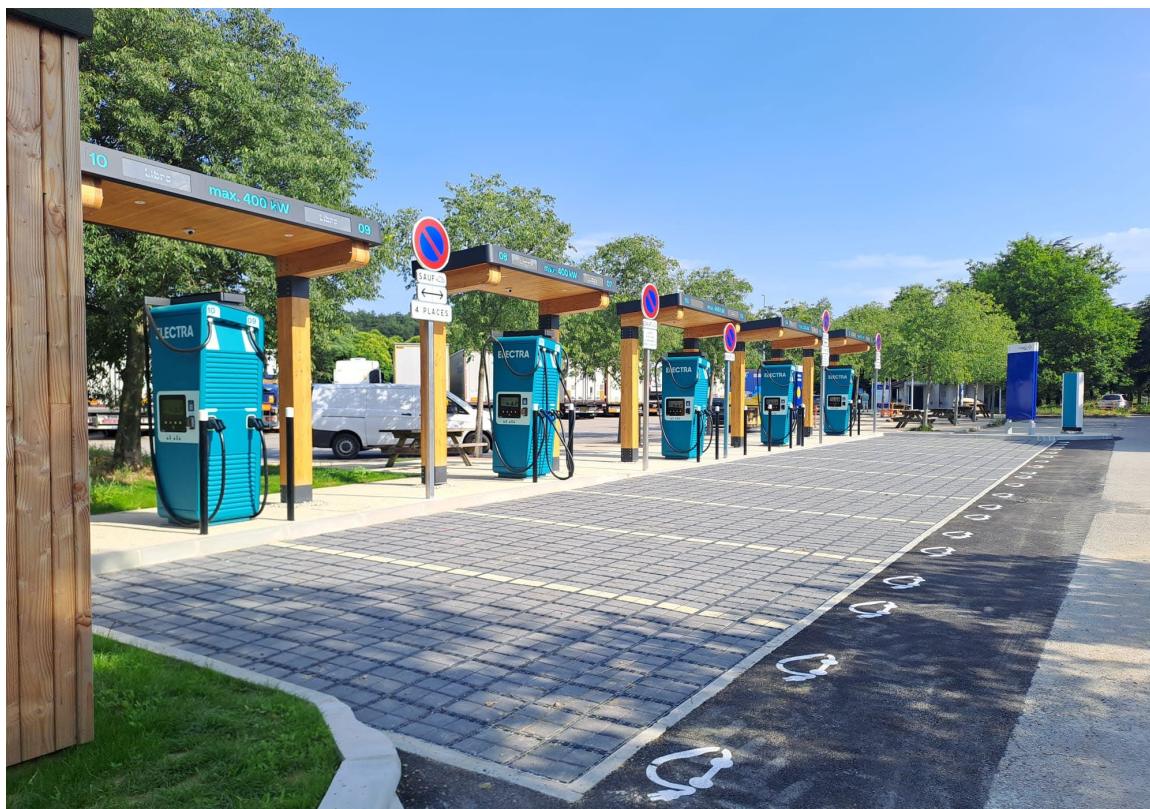
Station Electra sur l'aire de Bornaron (autoroute A7) dans la Drôme
