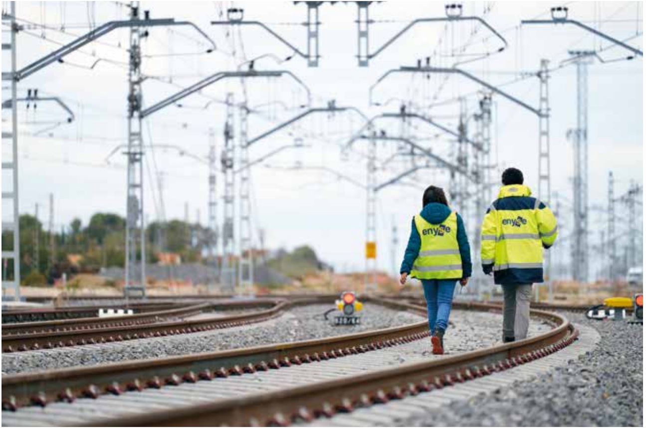
Installation et mise en service d'un nouveau système automatique de gare de triage au terminal intermodal de Vicálvaro, Madrid (Espagne).
