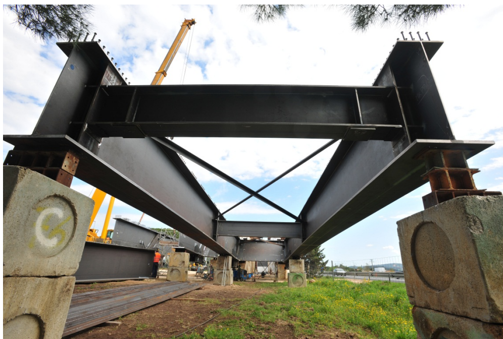
Les poutres métalliques sont assemblées au fur et à mesure pour former le tablier Photos Michel Martini
