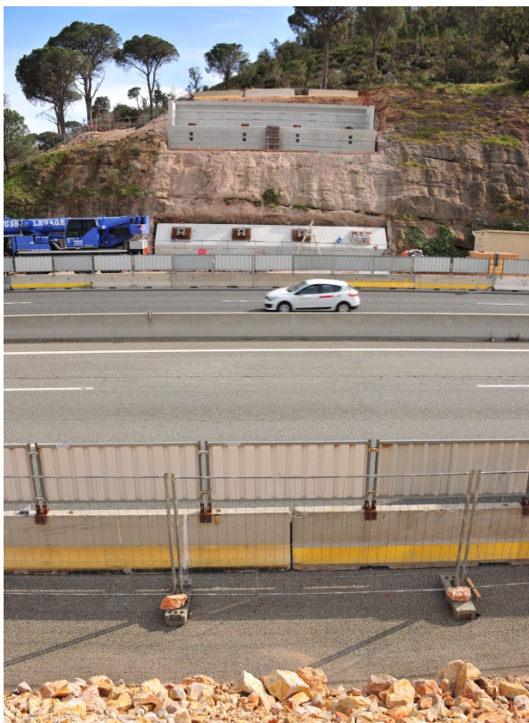
Les appuis latéraux de l'écopont situés de part et d'autre de l'autoroute A8
