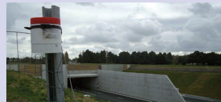
CAPTEURS À L'EXTRÉMITÉ DE LA TRANCHÉE COUVERTE
